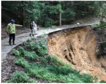
崩落箇所はゲートの手前500mの位置、松茸採取で入山した、松茸山を育てる会は、やむなく徒歩で現場へ。10月24日撮影
